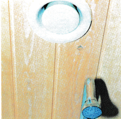
Figur 2. Udsugningsventil i loft til mekanisk ventilation.
